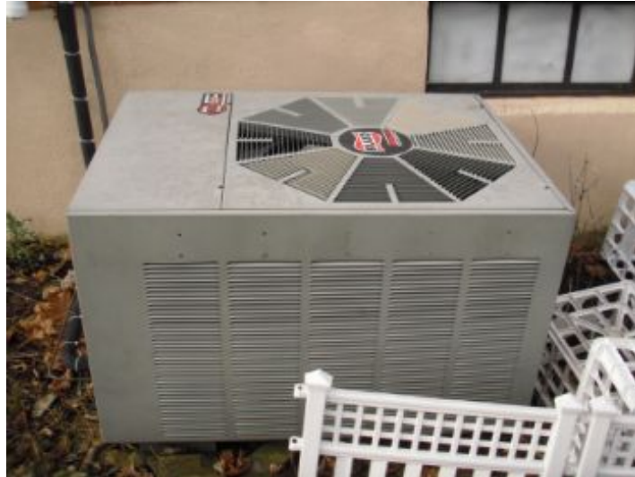
Ruud 2 ton A/C condensing unit.
